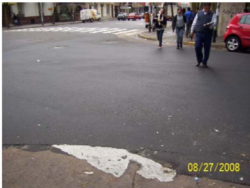
Foto IV: No se ha repuesto la demarcación horizontal (senda peatonal), luego de 17 meses de certificada la obra. Calle Mario Bravo.
