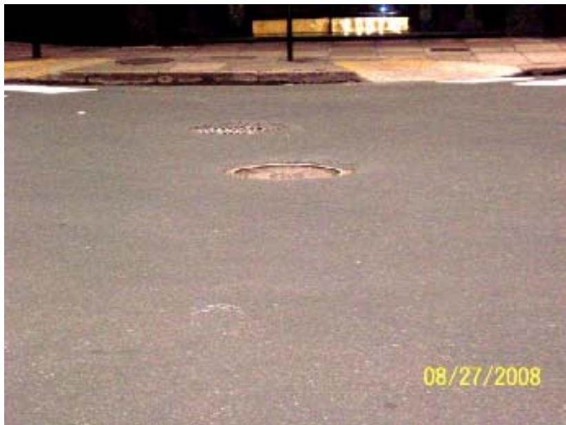
Foto III: Tapas no niveladas en trabajo de rehabilitación. Calle Billinghamurst y Arenales.
