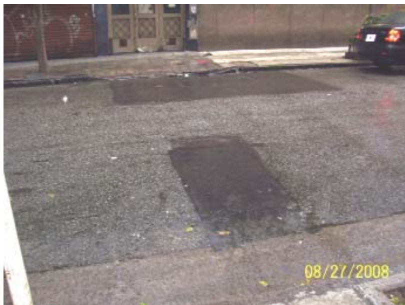
FOTO II Bacheo en hundimiento que no cubre la superficie total del Hundimiento.
